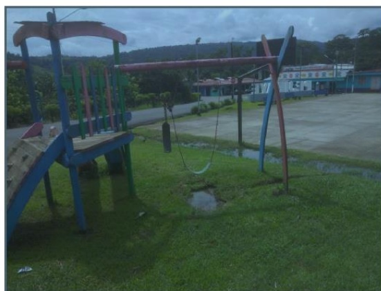
26-06-2024 (madera en estado de descomposición, debido a la humedad)
