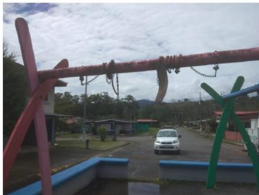
26-06-2024 (daños considerables en la estructura)
