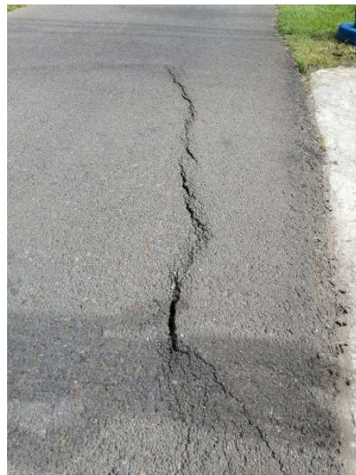
Fallamiento carpeta asfáltica
